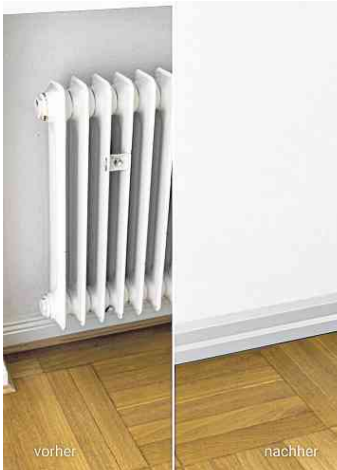
Eine Alternative, an die man nicht gleich denkt, die sich aber hervorragend zur Nachrüstung eignet: Die Fußleistenheizung
